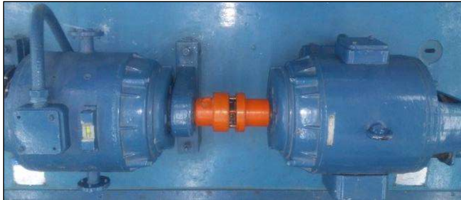
Figura 6.- Motor tipo jaula de ardilla acoplado mecánicamente a un generador de CD.
