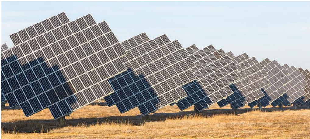
Figura 1.2 Condiciones de sombreado parcial en una granja fotovoltaica [5]
