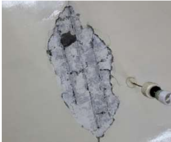
Figura 16. Lesiones mecánicas y físicas en losa, mercado Álvaro Obregón. Fuente: Ahumada S., 2022.
