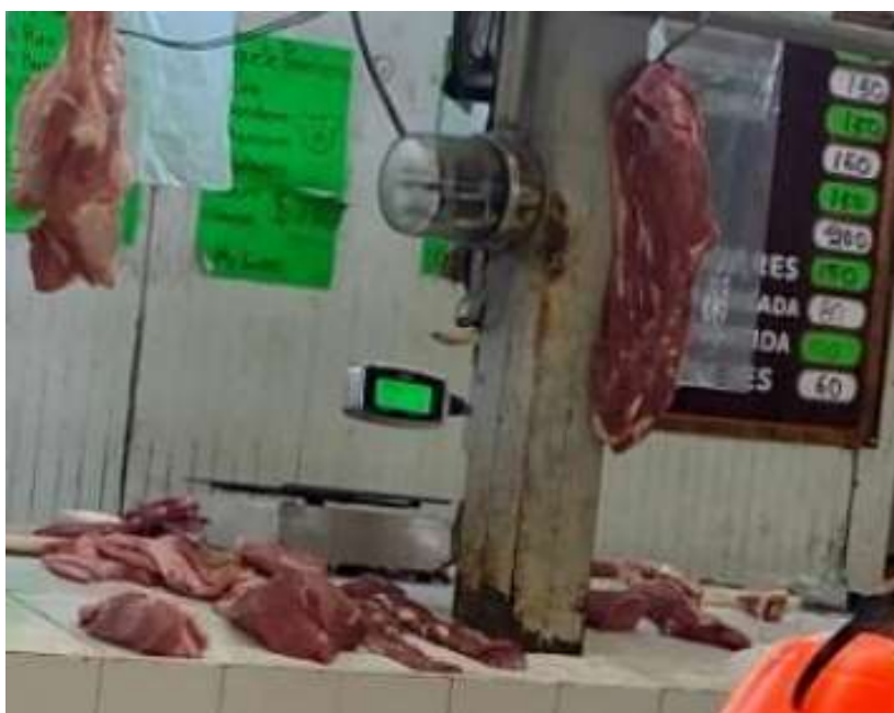
Figura 17. Lesiones físicas y mecánicas en columna de acero, mercado Álvaro Obregón. Fuente: Ahumada S., 2022.
