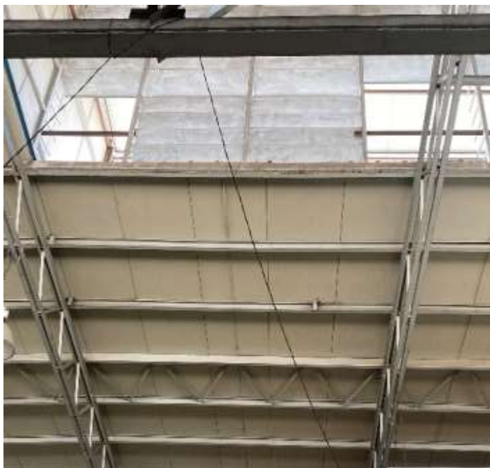
Figura 18. Lesiones físicas y mecánicas en armadura de acero. Fuente: elaboración propia, 2022.
