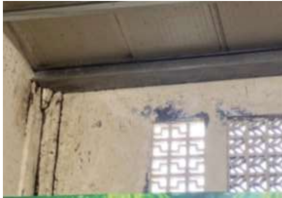
Figura 15. Lesiones mecánicas y físicas en muros, mercado Álvaro Obregón. Fuente: elaboración propia, 2022.
