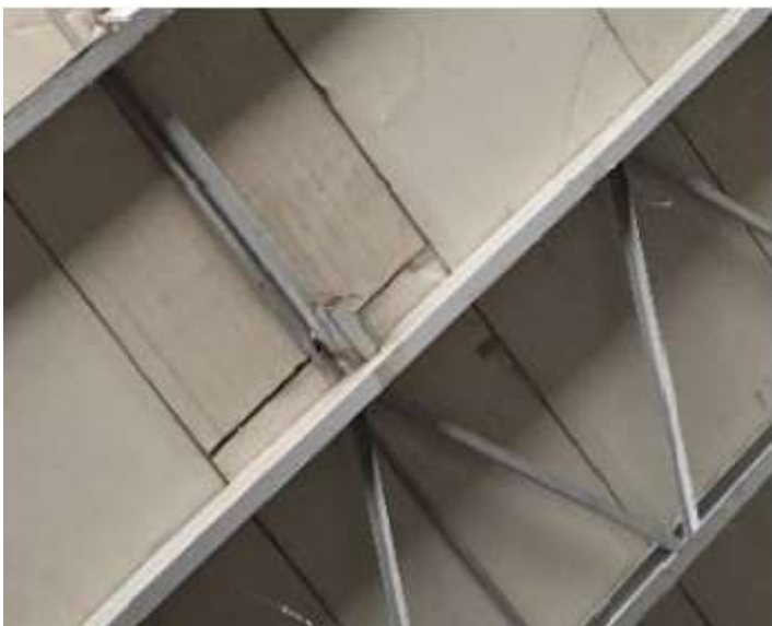
Figura 19. Lesiones físicas y mecánicas en cubierta de acero. Fuente: Ahumada S., 2022.
