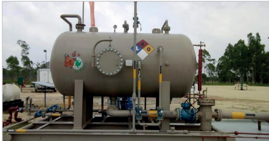
Figura 2.23 Separador trifásico horizontal (PEMEX, Instalación de BHJ con aparejos de BN,2020).
