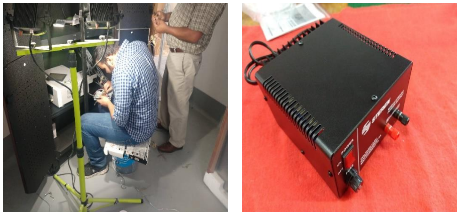
782 Figura 3.3 Instalación de sensores en el SCSHA.
