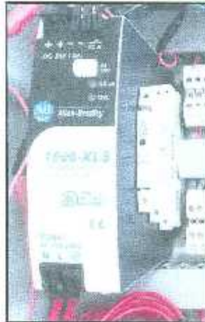
Figura 3.36. Fuente de alimentación marca Allen Bradley montada en gabinete eléctrico.
