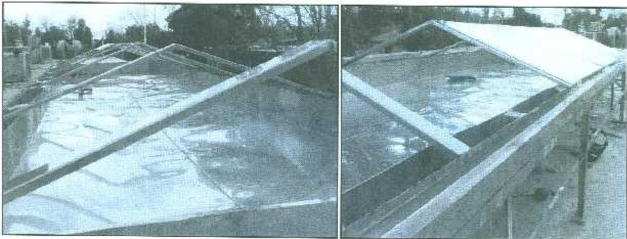
Figura 3.12. Soportes y cubierta transparente.
