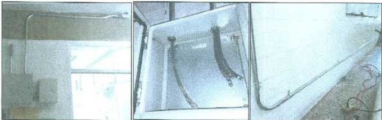
Figura 3.47. Etapa de instalación de tubería eléctrica y gabinetes de control planta baja.
