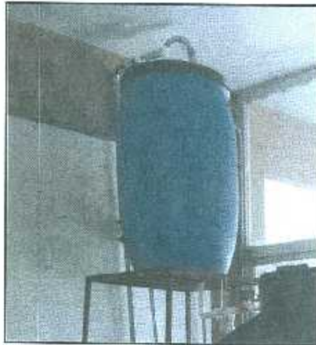
Figura 3.28. Montaje de sensor de nivel de agua destilada en tanque de almacenamiento diario.
