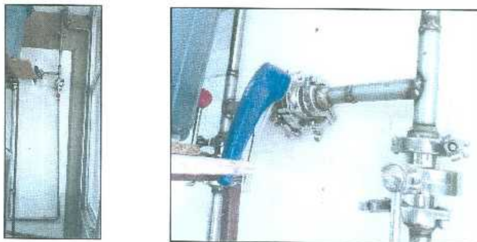
Figura 3.20. Bajada de tubería de agua destilada y purga, y bypass de en la línea de agua destilada para la habilitación o deshabilitación de U barométrica.
