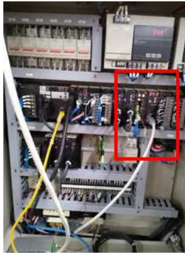
Figura 3.10 Gabinete de intervención con el PLC (Poka-yoke).
