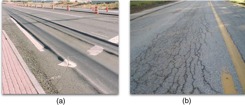
Figura 1.5 (a) Deformaciones permanentes a altas temperaturas o roderas, (b) agrietamiento por fatiga a bajas temperaturas.
