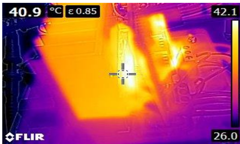
Figura 32. Foto térmica de la lectura de la cámara en el momento de ocurrir la falla.
