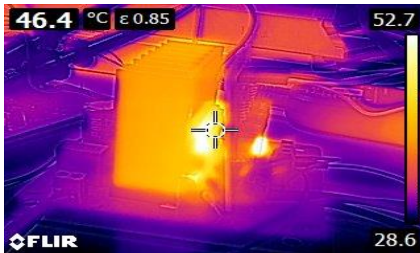
Figura 35. Foto térmica de la lectura de la cámara en el momento de ocurrir la falla.
